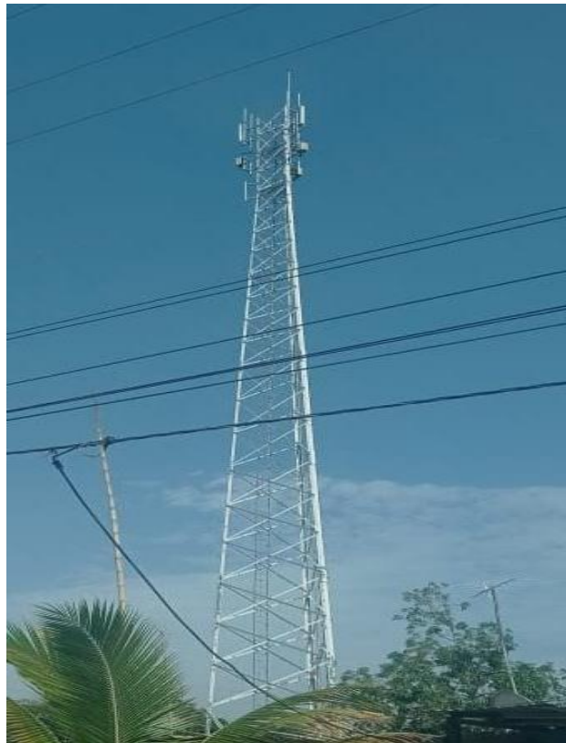
ANTENA REPETIDORA DE SEÑAL.
