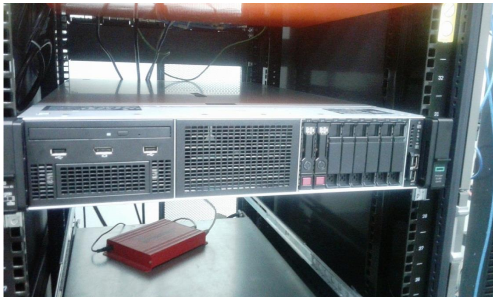
Ilustración 13 Rack donde se encontrará el nuevo servidor
