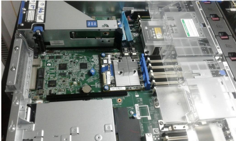
Ilustración 10 Parte interna del servidor ZEN GEN 10
