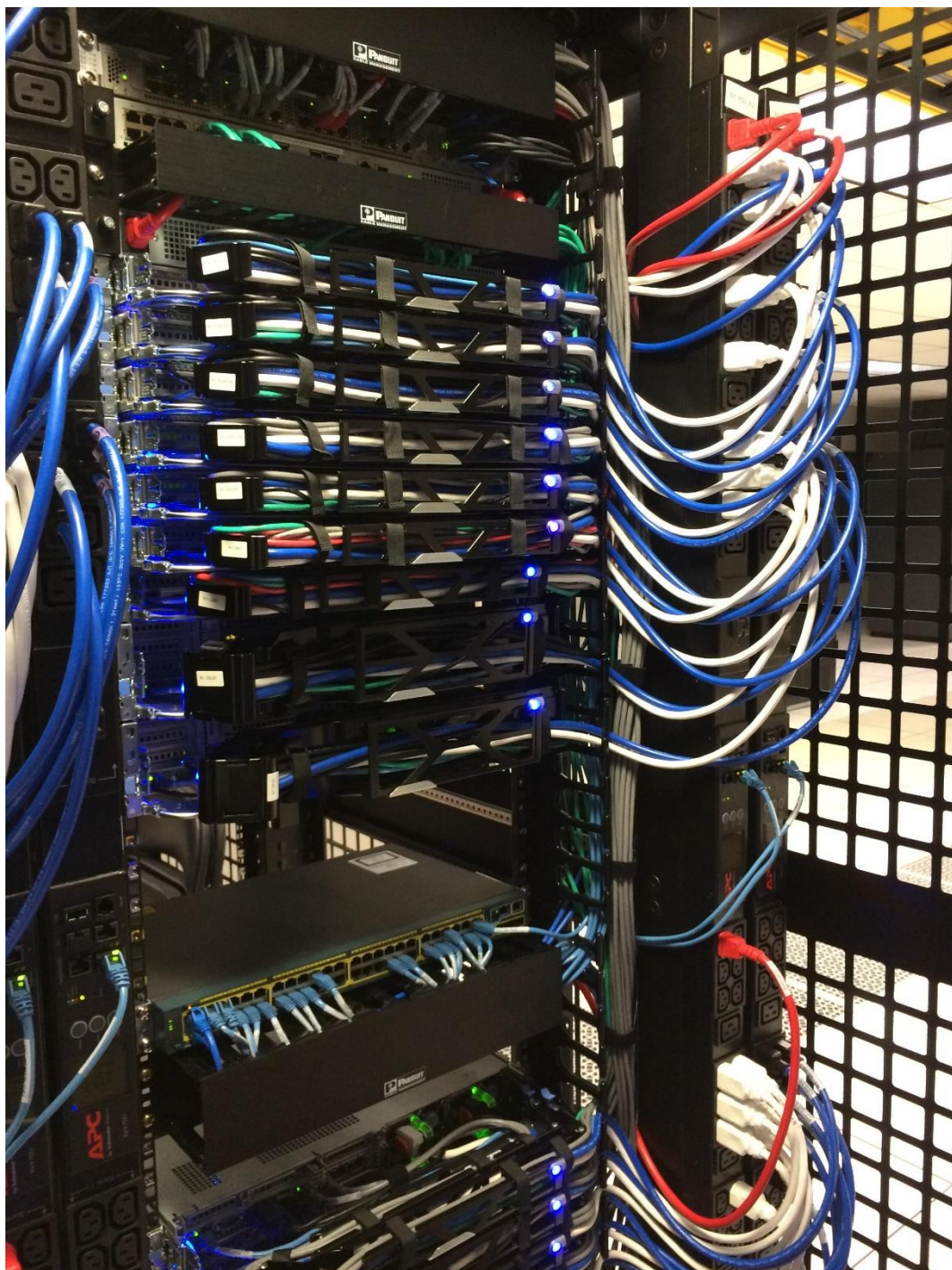
Foto 10.- Central de Almacenamiento, Servidores Dincom-Pacs (Eos) ESTACIONES
