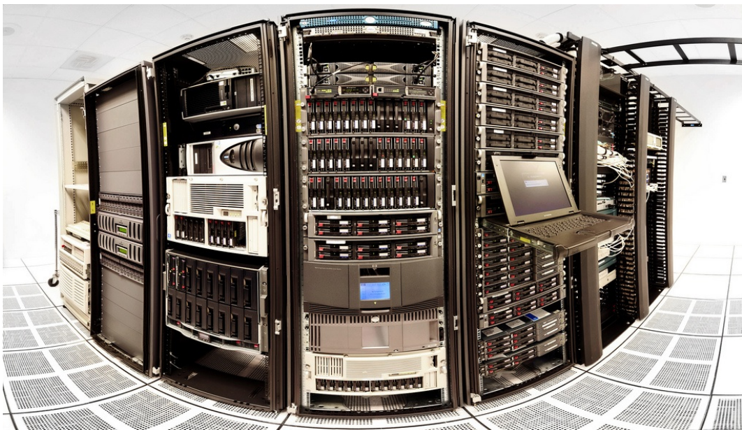
Figura 24. Cuarto de equipos - ER
