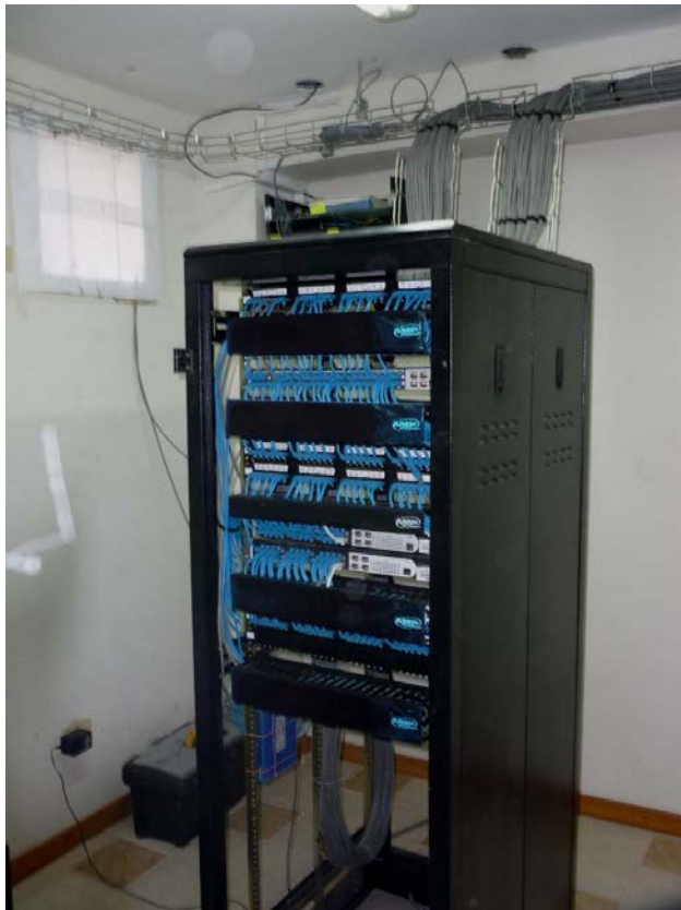
Figura 11. Gabinete de Telecomunicaciones
